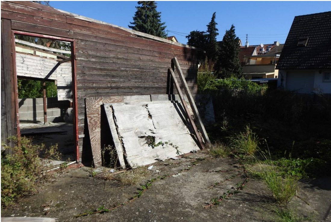
Abbildung 6: Rückwärtiger verfallener Schuppen mit gelagerten Holzbrettern
