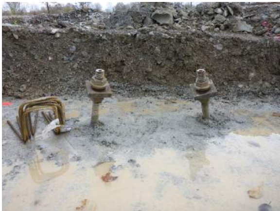
Zug-Pfähle mit Anschlusskappen (s.o.), Blitzschutz (s. rechts)
