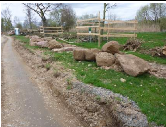
Erdarbeiten: Findlinge aus Sandstein, seitliche Lagerung und Wiederverwendung als Trittsteine im Gewässer
