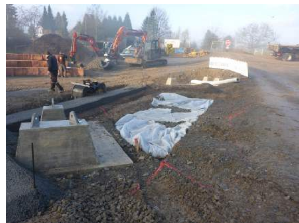
Mit Geotextil ummantelte Sickergrube II
