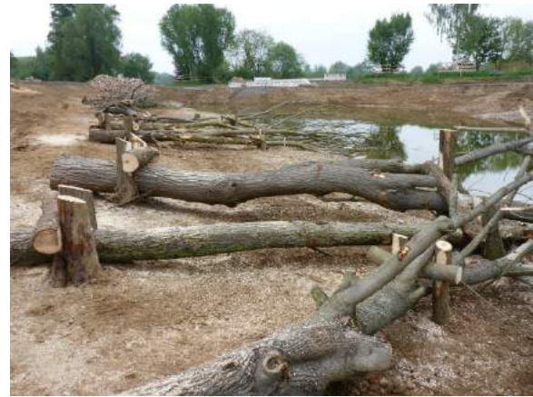
Totholzstrukturen: Die Pflöcke dienen zur Befestigung und Sicherung der Raubäume vor Wasserauftrieb.
