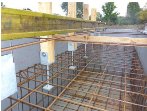
Stege und Plattform: Flachgründung, Balkenschuhe mittels Hilfskonstruktion aus Holz lagegerecht montiert (s. oben und Bild links)
