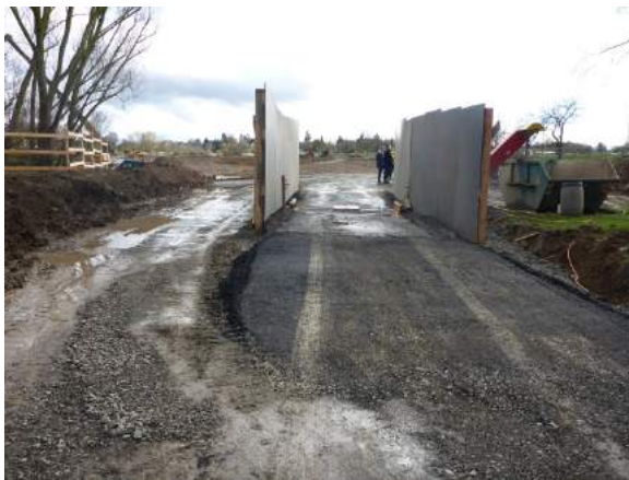
Reifenwaschanlage: Nachrüsten eines Spritzschutzes zur Vermeidung von Schadstoffeinträgen
