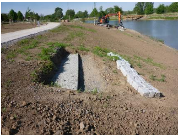
Sitzgelegenheiten am Ufer: Fundamentstreifen (Bild oben) Sitzblöcke fertig gestellt, Sandsteinblöcke, eingefasst mit Granit (s. links)
